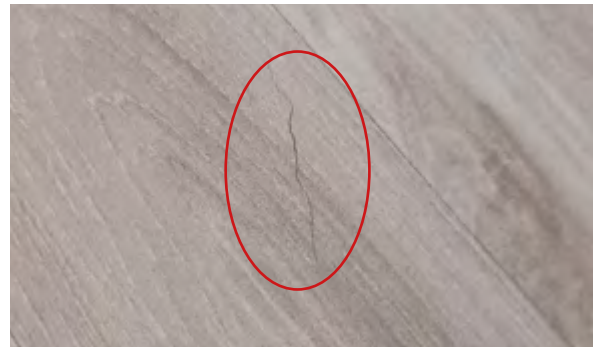
Figure 7.22. Fissure centrale due à la non-uniformité de la charge de l'alvéole
