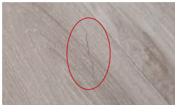
Figura 7.22. Grieta central debida a desuniformidades en la carga del alvéolo.
