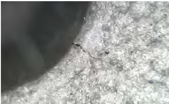
Figura 7.24. Microgrieta en la zona redondeada de un formato sinfín.
